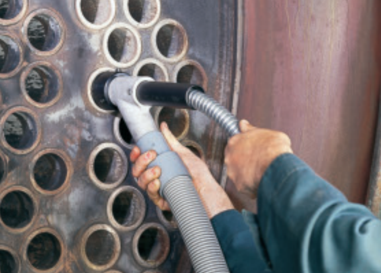
El Wils-Away™ 1000 Limpiando una Caldera Piro Tubular
